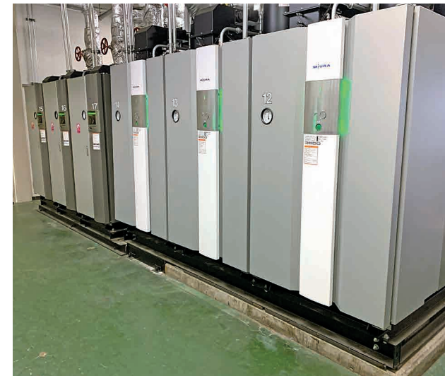
蒸気ボイラー
