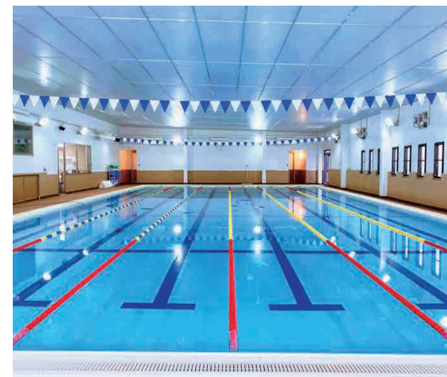
スポーツジムでの給湯・冷暖房
